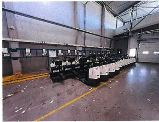
Bouwdeel A: Acculaadstation
